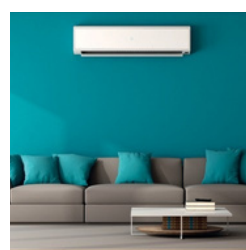
Riscaldamento con ventilconvettori
